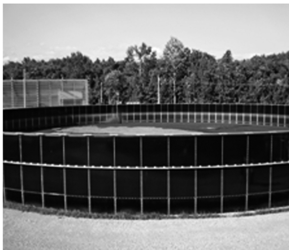
図2 鹿追バイオガスプラント 消化液貯留槽
