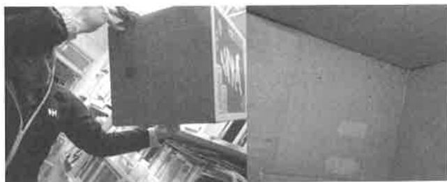
図-2 箱外（左）および内部（右；浅川 [4] より）の目視検査
