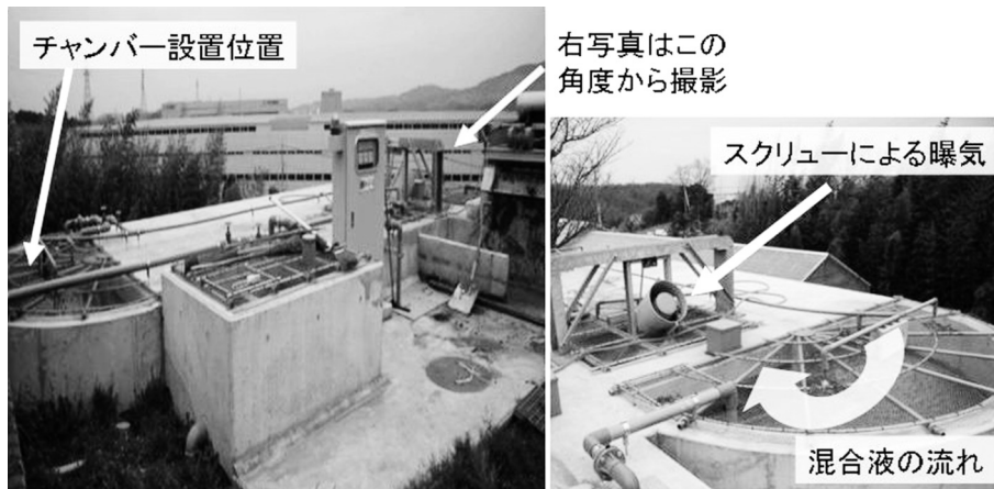
図1 A酪農家において稼働していたオキシデーション・ディッチ型(O型)の曝気槽。混合液が大気と接している部分(金網部)の面積は8.04 m 2 であった。
