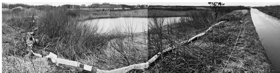
写真1 親船名無沼に約 50 m 設置されたフェンストラップ
