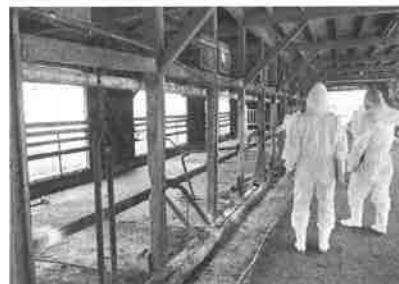
写真4 2011年11月の畜舎内の様子。牛の死骸や糞尿は全て片づけが完了していた。
