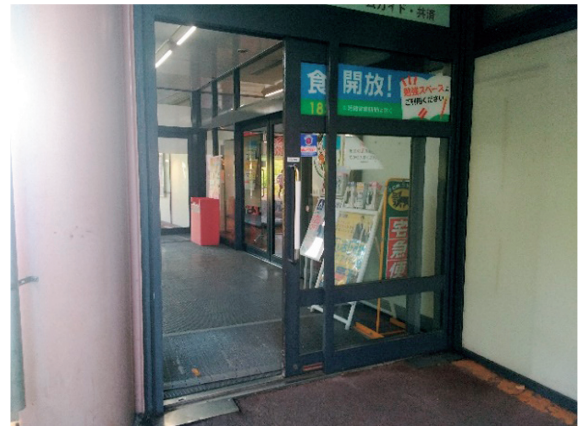
写真 1 入口の段差 (学園ホール)
